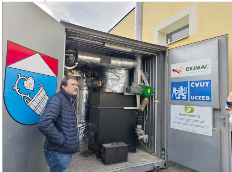
Snímek kogenerační jednotky v obci Míkolajice, jehož fungování vysvětluje účastníkům exkurze pan Martin Krupa, který byl zdejším dlouholetým starostou a také je expertem na měření a regulaci energetických systémů solárních elektráren.
